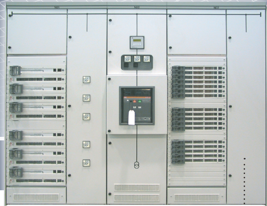
Dreifeldrige Musteranlage (1 Einspeisung, 2 Abgangsfelder)
