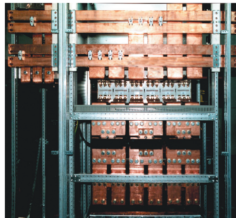
Sammelschienenraum eines 4000 A Leistungsschalters
